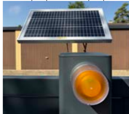
Alimentation solaire en cas d'absence de liaison électrique.
