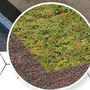
Gestion de l'eau pluviale avec plantes sédum
